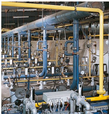
Línea de gas en una fábrica de ladrillos
