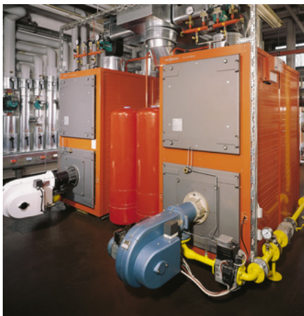
Control de la presión de entrada del gas en calderas de calefacción de mayor potencia
